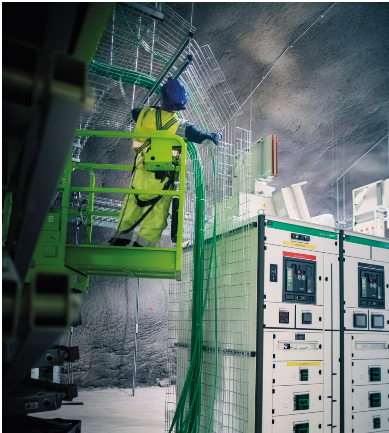
La collocazione nelle gallerie dei quadri elettrici del Data Center
